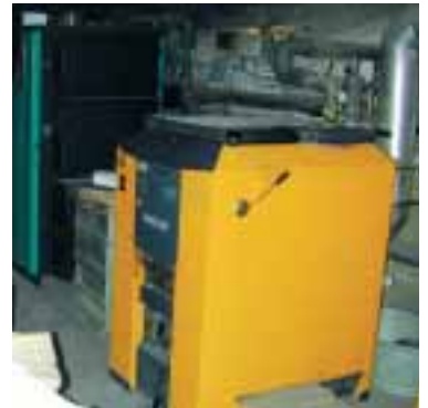
Der Stückholzkessel als unterstützende Komponente des Heizungssystems.
