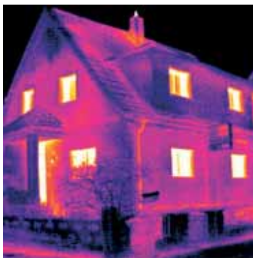
links: Dämmung der Gauben rechts: Thermogramm
