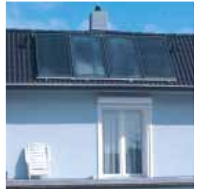
Flachkollektoren unterstützen die solare Warmwasserbereitung.
