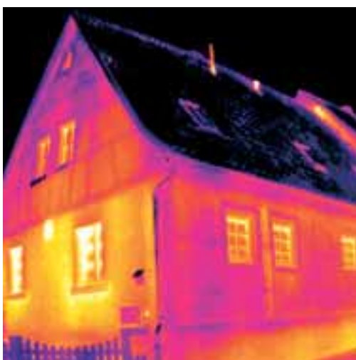
Thermogramm Straßenseite / Giebel
