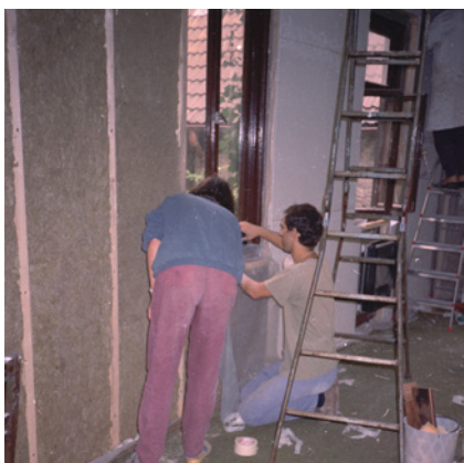
Innendämmung aus Mineralfaserplatten mit Dampfbremse; hier die Herstellung des Anschlusses am Fensterrahmen
