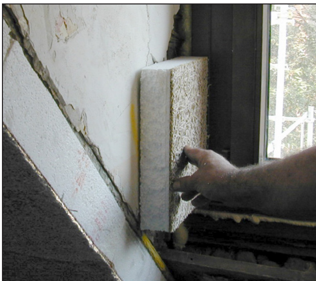
Die Dämmschicht wird, wie an dieser Gaubenwand, bis an den Fensterrahmen geführt.
