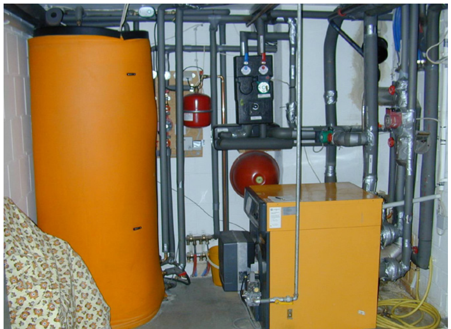
Geeigneter Aufstellungsort für den Speicher ist meist der Heizungskeller – der Anschluss des Heizkessels für die Nachheizung ist leicht möglich.
