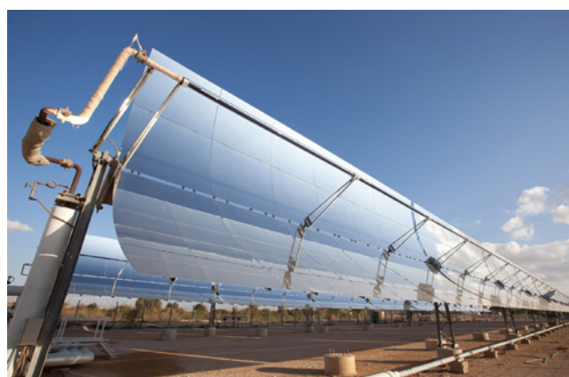
Kollektor eines Parabolrinnenkraftwerks Foto: SIEMENS
