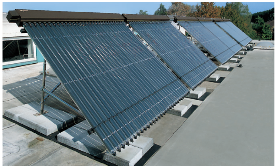
Feld aus Vakuumröhrenkollektoren, aufgeständert auf einem Flachdach
