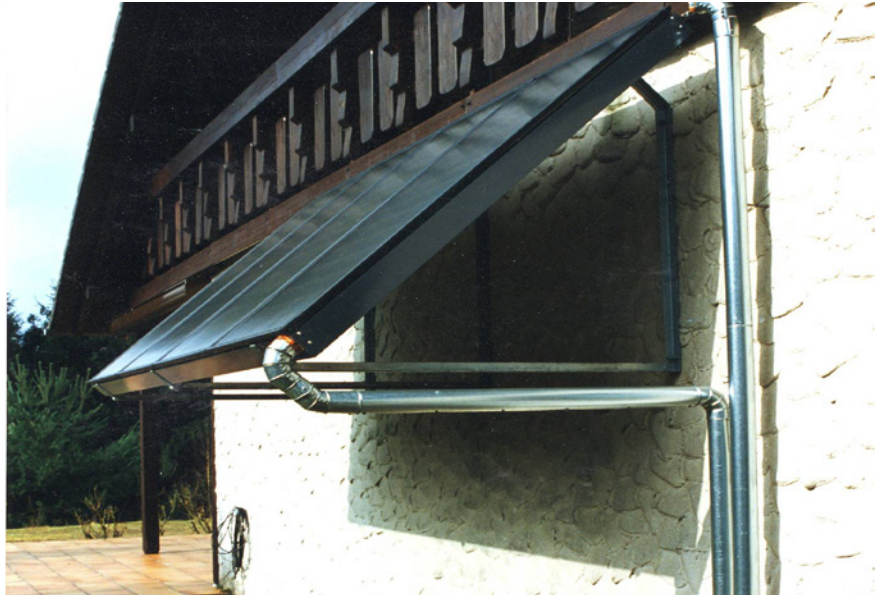
Ein an der südorientierten Giebelwand montierte Flachkollektoranlage. Eine Lösung für Bestandswohngebäude, bei denen die Dachfirste leider vorwiegend in Nord-Südrichtung orientiert sind.
