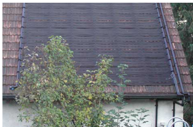
Dachfläche mit Absorbermatten
