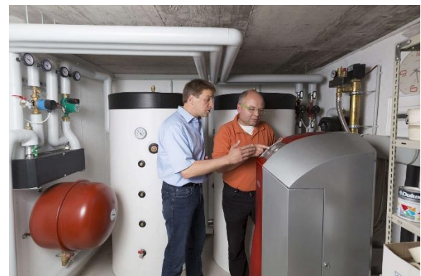
Bildquelle: Bundesverband Wärmepumpe (BWP)
