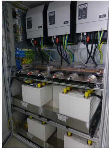
Bild 19: Lithium-Ionen-Batterien des elektrischen Energiespeichers sowie Batteriewechselrichter
