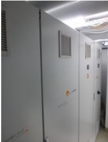
Bild 18: Außenansicht des elektrischen Energiespeichers
