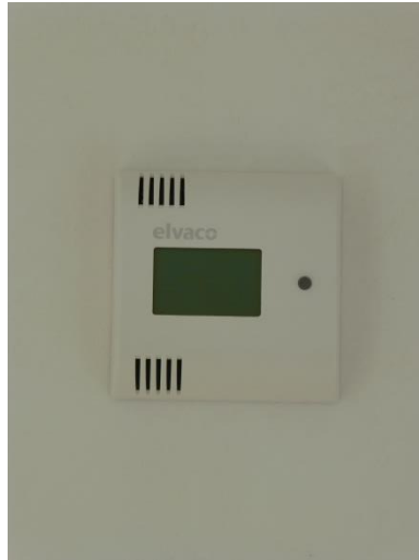
Bild 24: Raumtemperatur und Raumluftfeuchtesensor in einem Wohnraum
