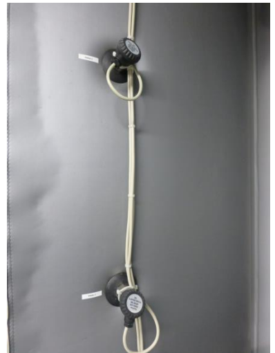
Bild 28: Temperatursensoren am Pufferspeicher
