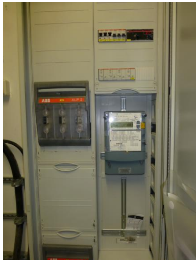
Bild 27: Übergabezähler am Hausanschluss
