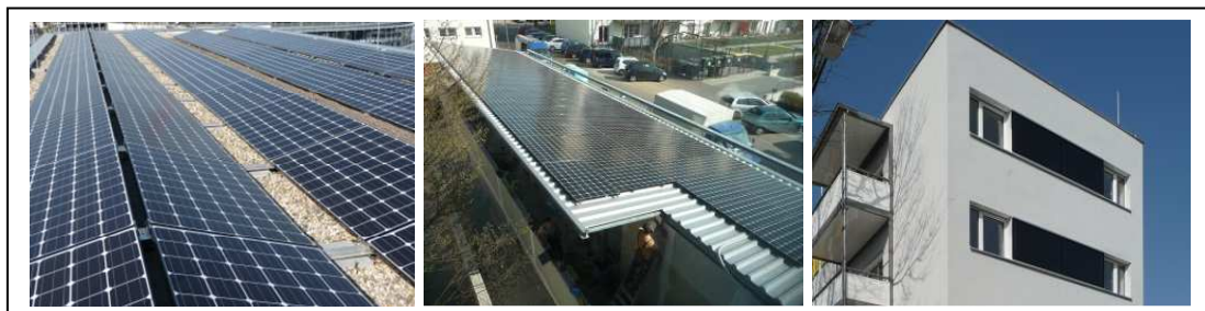
Bild 8: Photovoltaik auf Dach (links), Carport (Mitte) und an der Südfassade (rechts)
