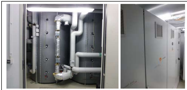
Bild 7: Pufferspeicher Wärme (links) und elektrischer Energiespeicher (rechts)
