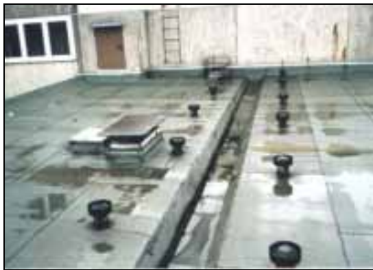
Ansicht des Flachdaches mit Wasseransammlungen
