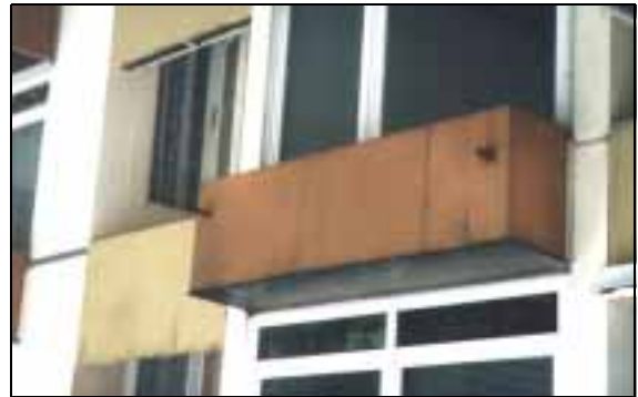
Pflanzkübel aus Beton, direkt an die Geschossdecke anbetoniert
