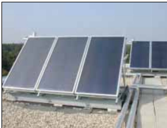
Flachkollektor auf dem Dach
