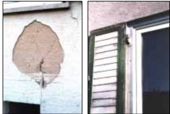
Risse und Schaden am Außenputz
