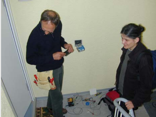
Bild 37: linkes Bild: Installation einer Messdose im Treppenhaus Rechtes Bild: Messdose im 3. Obergeschoss mit zwei Temperatur- und vier Feuchtemessstellen; die Dose ist sonst durch eine Abdeckung verschlossen
