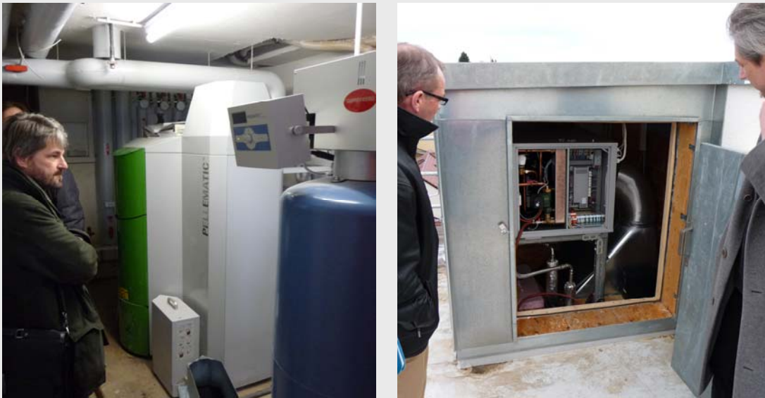
Abbildung 5.3-2: Die Anlagentechnik: Heizraum mit Pelletkessel (links) und Abluftwärmepumpe in einer gedämmten Einhausung auf dem Flachdach (rechts).
