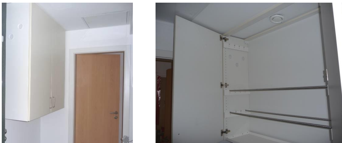
Abb. 7.9: Abluft-Trockenschrank im Bad
