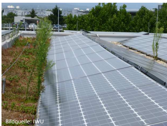
PV-Dachanlage nach einem Jahr
